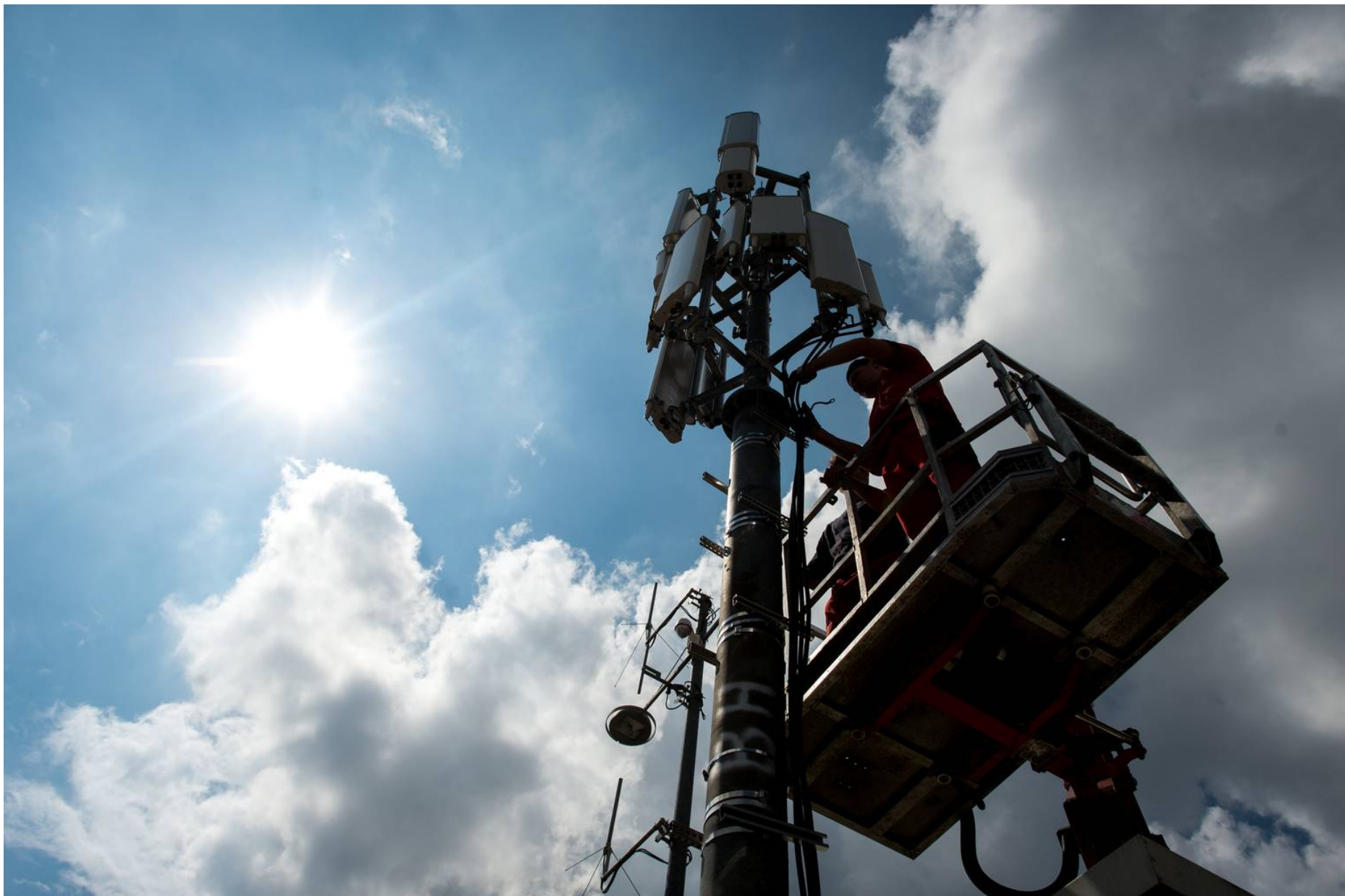
Die Telekom betreibt 111 Standorte zur Mobilfunkversorgung im Kreis Viersen.
